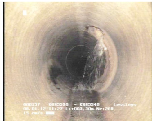
Abbildung 2 K685530 bis K685540 Station 03,68 m in Fließrichtung
