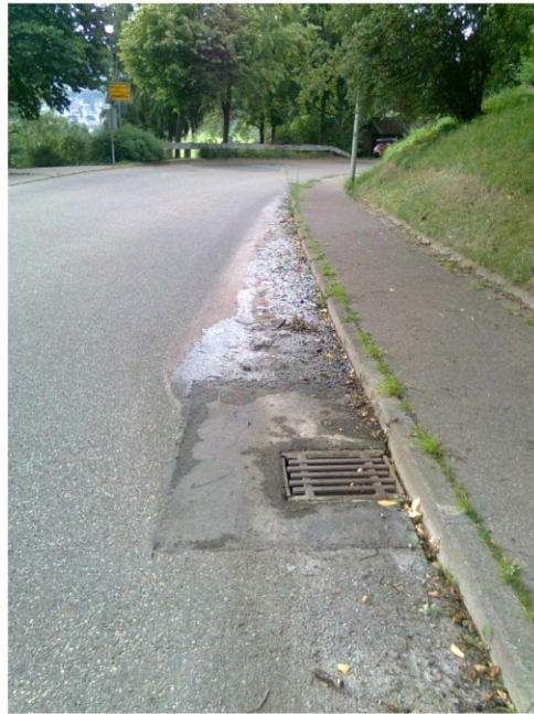
Abbildung 3 Pflützen nach Wasseraustritt aus Straßenablauf
