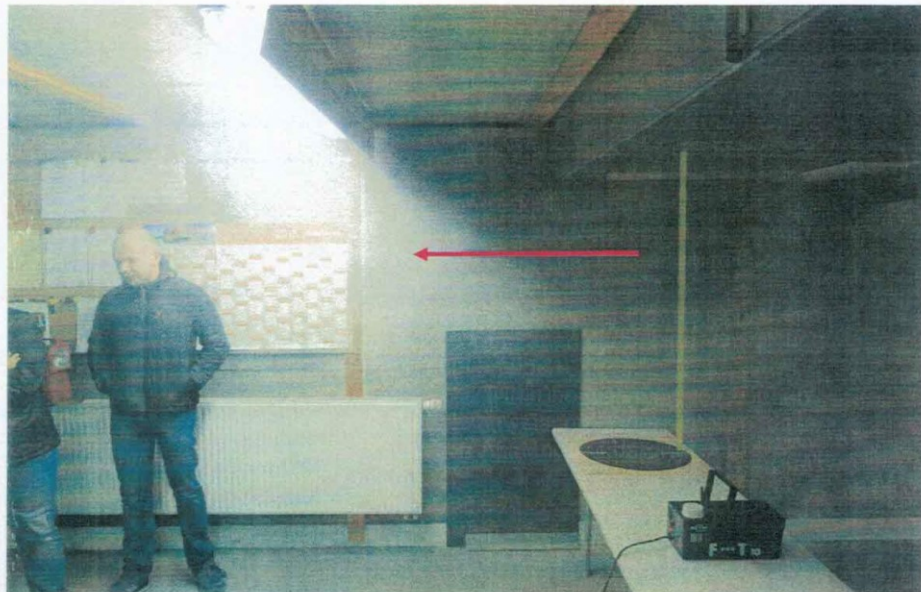
deutlich sichtbare Rückströmung in den Schützenstand beim Nebeltest
