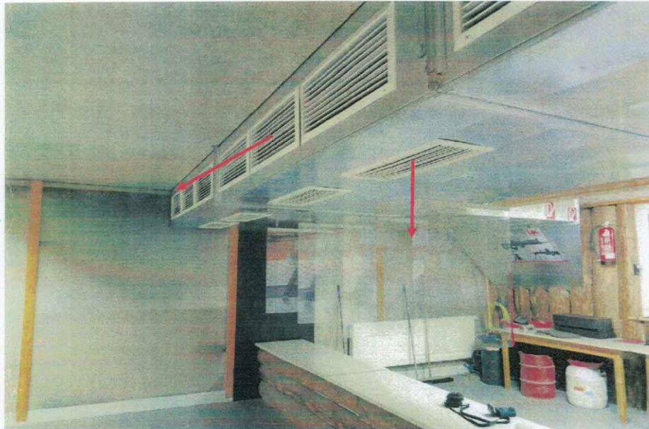
Zuluftführung vor den Schützenständen nach unten und vorne aus Lamellenauslässen führt zu Verwirbelungen und Rückströmungen. Die Anlage ist umzubauen.
