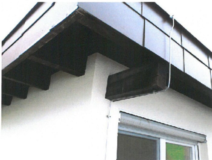
Abb.: AC050312.IRB - Außenwand Undichtigkeiten am Rollladen sowie im Bereich des Dachanschlusses
