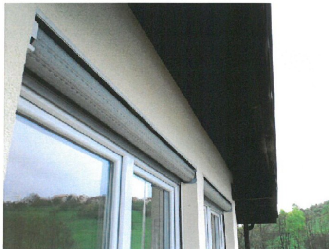
Abb.: AC050310.IRB - Außenwand Küche Undichtigkeiten am Rollladen sowie im Bereich des Dachanschlusses
