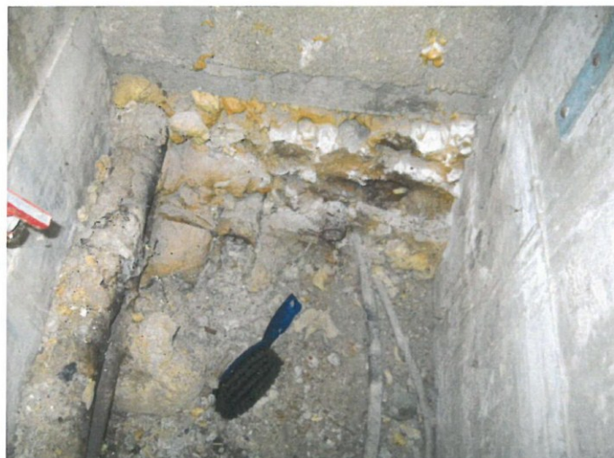
Abb. 2: Schacht im Technikraum
