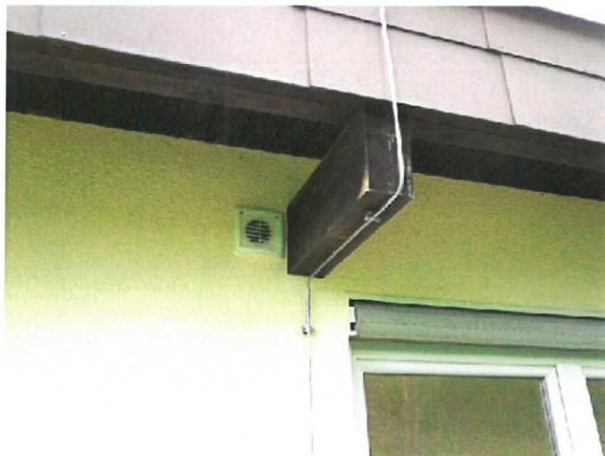
Abb.: AC050307.IRB – Abluftgitter im Gruppenraum
