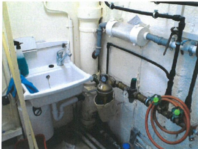
Abb.: AB050312.IRB - Technikraum Fallrohr, vermutlich mit angeschlossener Dachentwässerung
