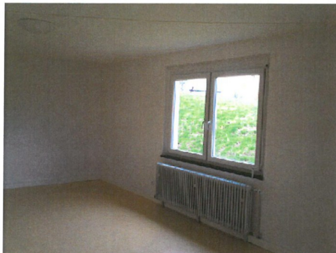
Abb.: AB050304.IRB - Gruppenraum Leckagen im Bereich der Fenster; wärmetechnische Schwachstelle in der Dachkonstruktion im Bereich der Deckenleuchte. Ggf. ist die Temperaturabsenkung auf die starke Pfützenbildung des Flachdachs in diesem Bereich zurückzuführen. Genauere Prüfung des Dachaufbaus ist in diesem Bereich zu empfehlen.
