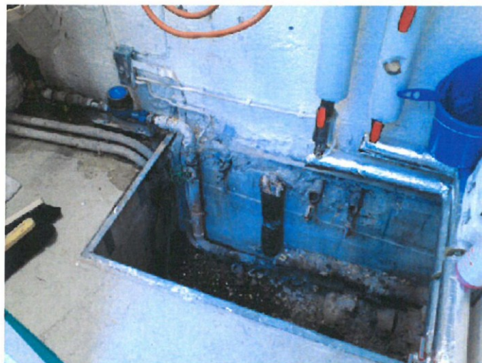
Abb.: AB050311.IRB - Technikraum Schacht im Technikraum
