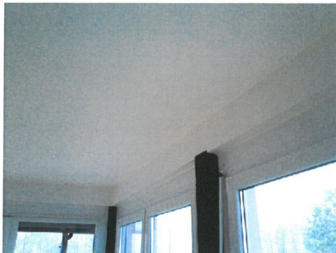
Abb.: AA050309.IRB - Büro Undichtheiten im Bereich der Fenster (Kurbeldurchführung)
