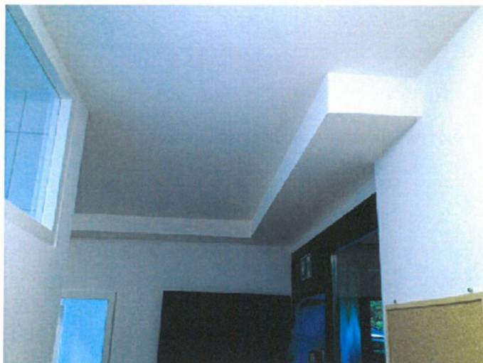
Abb.: AB050309.IRB - Flur (Eingangsbereich) Wärmetechnische Schwachstelle in der Dachkonstruktion des Eingangsbereichs. Genauere Prüfung des Dachaufbaus ist in diesem Bereich zu empfehlen.
