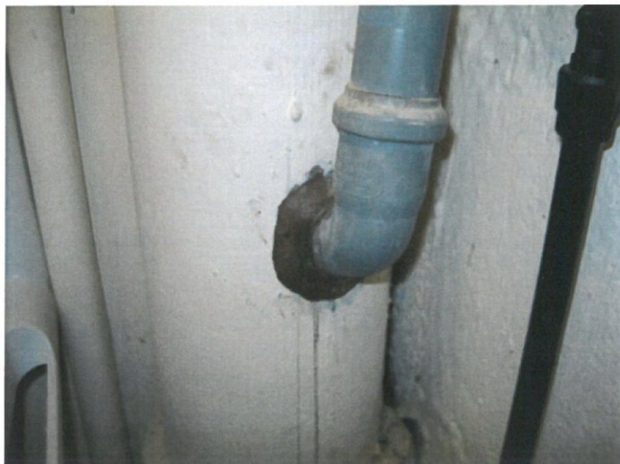
Abb. 4: Undichter Anschluss des Kondensateinlaufs der Brennwerttherme
