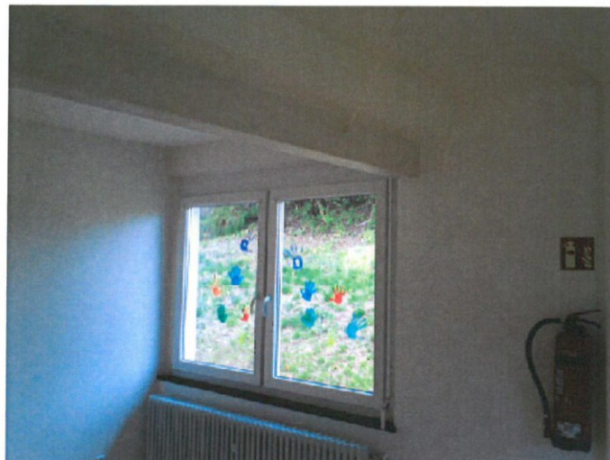
Abb.: AB050307.IRB - Gruppenraum Luftundichtheiten im Bereich des Fensters sowie der Schachtverkleidung einer Abluftleitung
