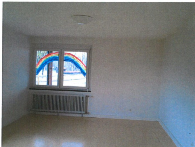
Abb.: AB050300.IRB - Gruppenraum Undichtheiten im Bereich von Steckdosen in der Außenwand sowie im Bereich des Fußbodenanschlusses unter dem Heizkörper
