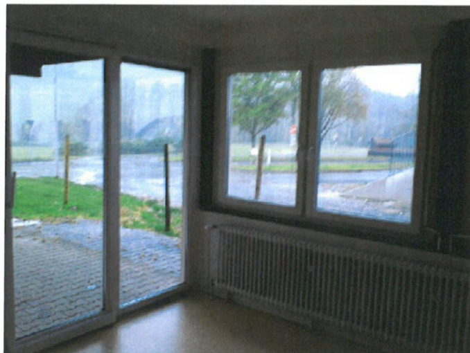
Abb.: AA050307.IRB - Büro Undichtigkeiten im Bereich der fenster
