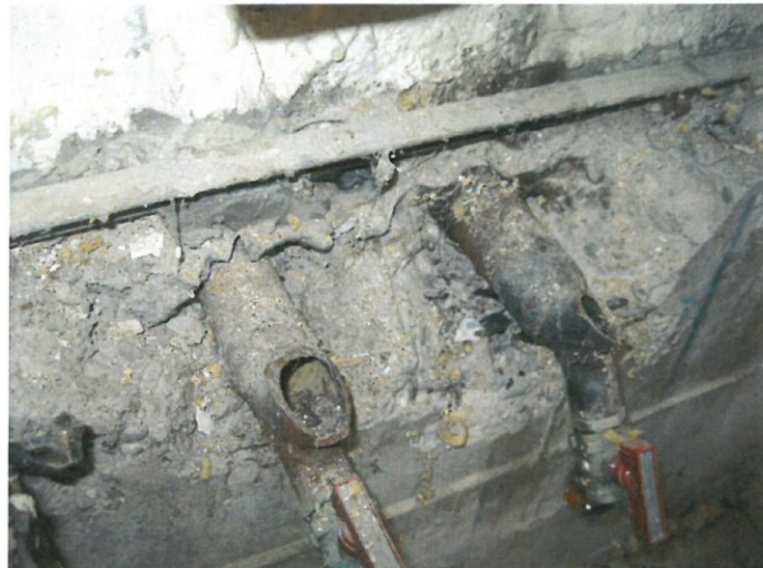
Abb. 3: Korrodierte Leitungen im Schacht
