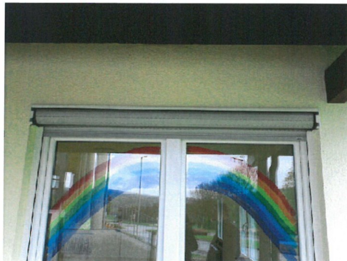
Abb.: AC050303.IRB - Außenwand Gruppenraum Undichtigkeiten am Rollladen sowie im Bereich des Dachanschlusses
