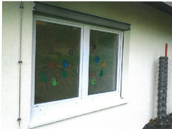
Abb.: AC050308.IRB - Außenwand Gruppenraum Undichtigkeiten am Fensterbank und im Bereich des Rollladens
