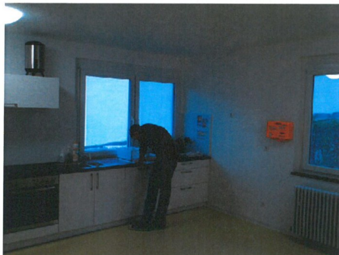
Abb.: AA050302.IRB - Küche Leckagen im Bereich der Steckdosen der Außenwand sowie im Bereich des Fensters und dem Fußbodenanschluss links neben dem Heizkörper
