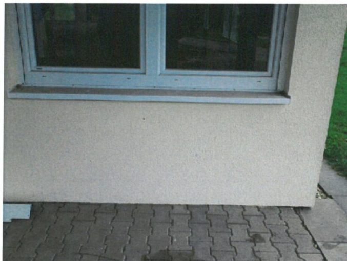
Abb.: AC050304.IRB - Außenwand Gruppenraum Undichtigkeiten im Bereich des Fensterbanks sowie im Sockelbereich der Fassade
